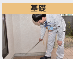
ひび割れ、欠陥や劣化等
