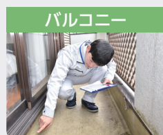
ひび割れ、劣化等
