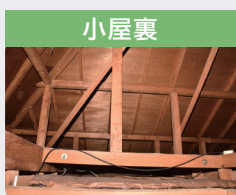
雨漏りの跡、腐朽等
