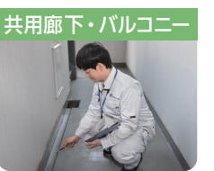
ぐらつき、ひび割れ等
