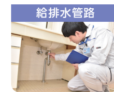
水漏れ、排水不良、滞留等
