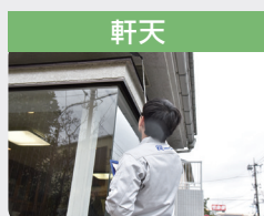
雨漏りの跡、ひび割れ
