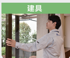
開閉不良、外壁との隙間
