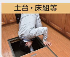
ひび割れ、劣化、蟻害等
